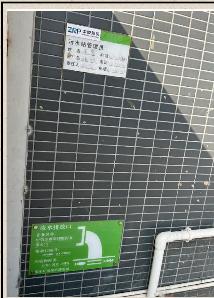
中荣污水处理站实景图
